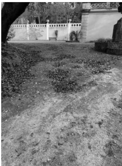
Figura 66 – Zona Plana em saibro estabilizado com pavimento degradado.
