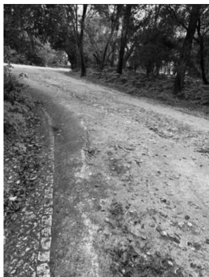
Figura 65 – Pavimento em saibro estabilizado com sulco central (a valeta não cumpre a função).
