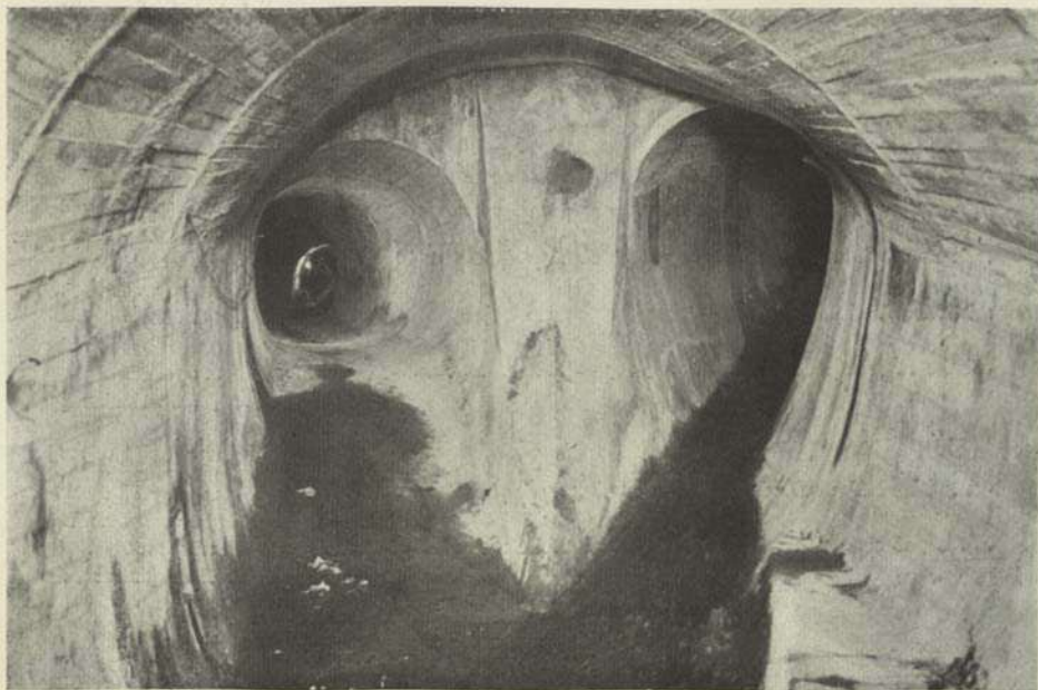
A JUNÇÃO DO VELHO COLECTOR DE ALMIRANTE REIS (A DIREITA) COM O NOVO COLECTOR DO REGUEIRÃO
