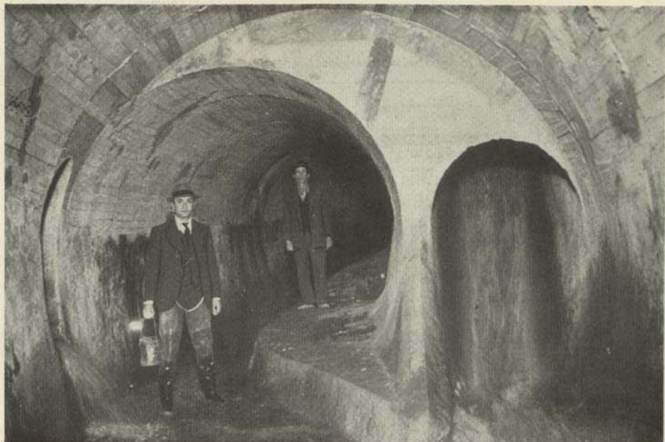
LIGAÇÃO DE 2 COLECTORES E 1 RAMAL, SOB A RUA DA PALMA, (VENDO-SE UM DOS ENGENHEIROS DA C. M. L. E UM FISCAL EM VISITA DE INSPECCAO)
