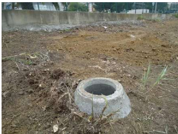
Figura 4.11 - Caixa de visita de águas pluviais na extremidade Sudoeste do terreno, após desmatamento
