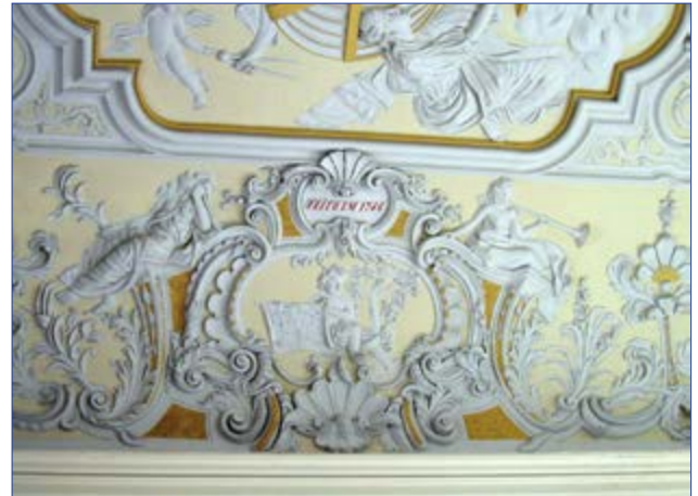
Figura 6 Convento do Grilo, em Lisboa. Cartela do teto da escadaria principal. Fotografia de Isabel Mendonça.
