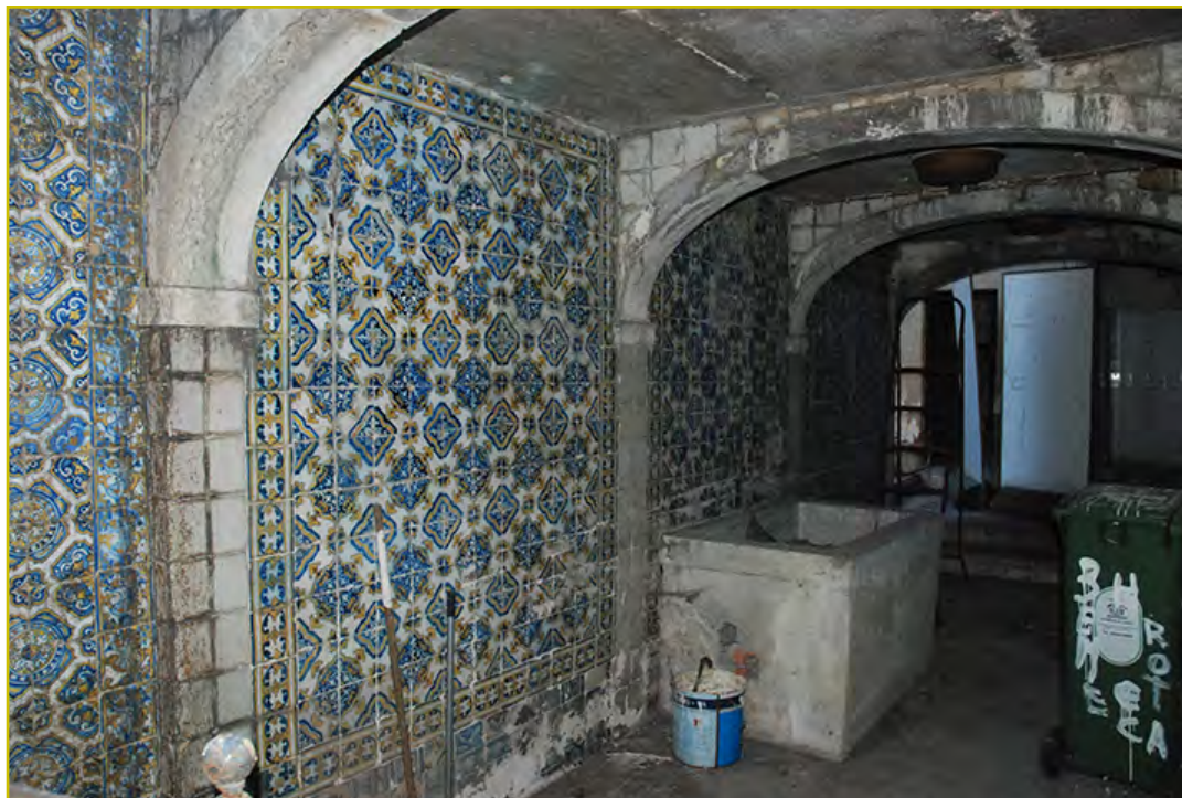
Figura 6 Aspeto geral do interior da estrutura arquitetónica associada à cisterna, onde se preserva uma cuba de pedra e alvenaria. Fotografia do autor, 28-11-2013.
