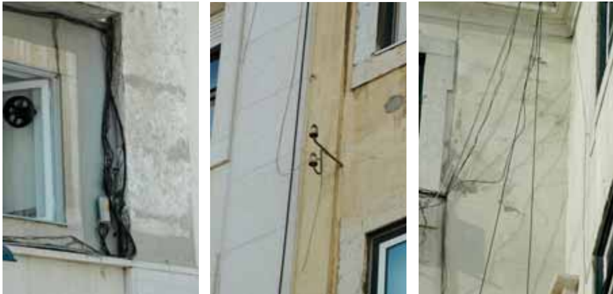
Fig. 23 – Redes pelo exterior e unidades de climatização (condensação).
