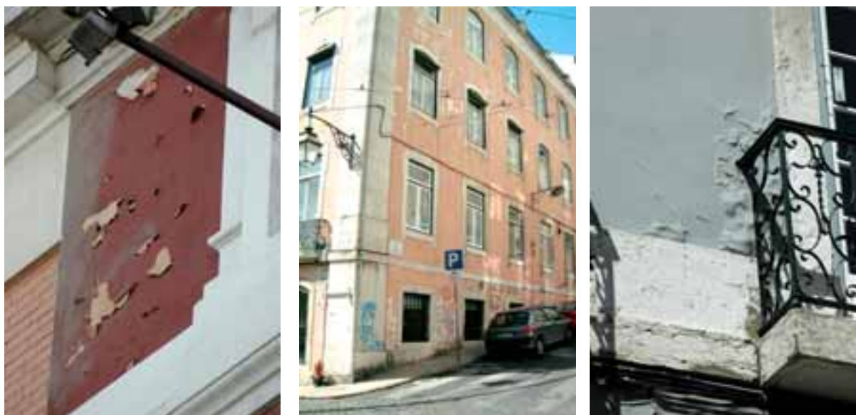
Fig. 21 – Exemplos de efeitos de destacamentos de tintas texturadas dos suportes.
