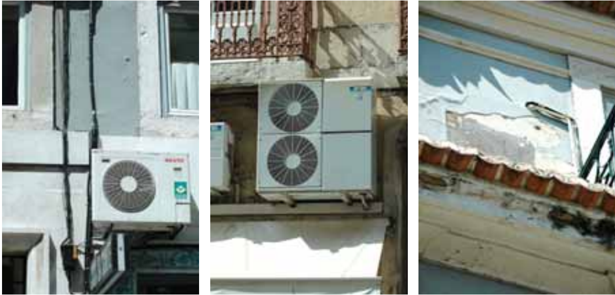
Fig. 22 – Unidades de climatização (condensação).
