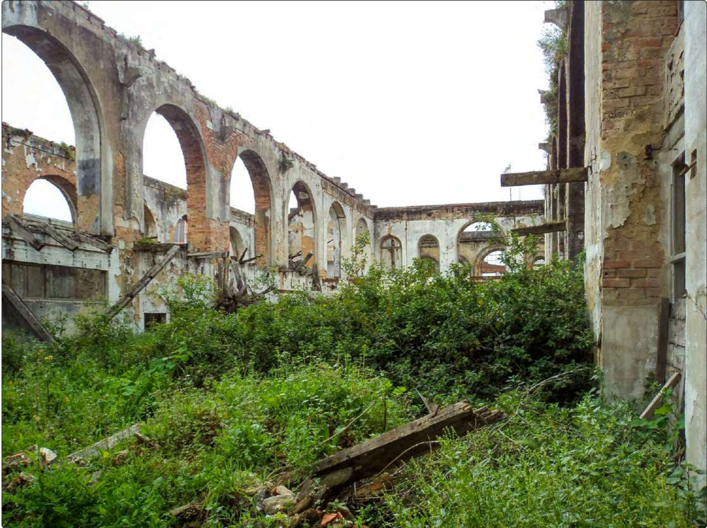
Fig 10 Vista de um antigo complexo fabril em ruínas, em Xabregas. Francisco Bugalhão de Campos. 2014. FA-UL.
