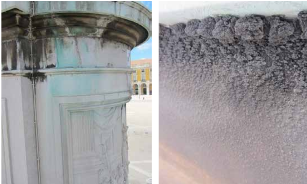
Fig.3 - Aspecto da sujidade em áreas mais abrigadas. À direita um pormenor de sujidade incrustada, de tipologia “crosta negra”. As manchas esverdeadas são devidas à deposição de compostos de cobre lixiviado do conjunto da estátua equestre.
