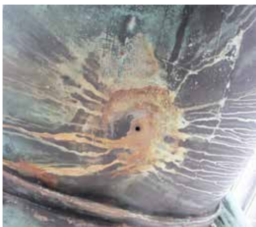
Fig. 9 – Manchas castanhas e “escorrimentos” verdes na pátina preta.
